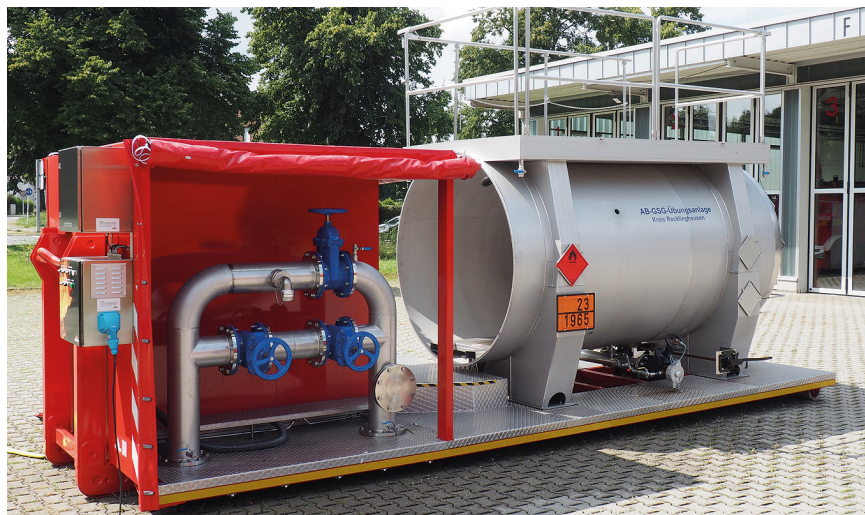
Blick auf den Abrollbehälter in Fahrtrichtung links mit Rohrleitungssystem und Tankatruppe
