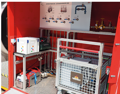
Blick in den Geräteraum
